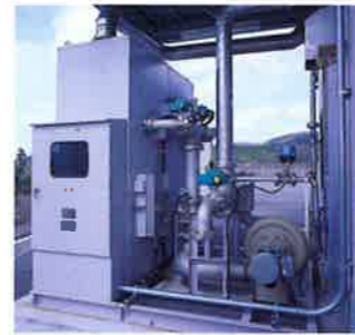
EOG排ガス処理
