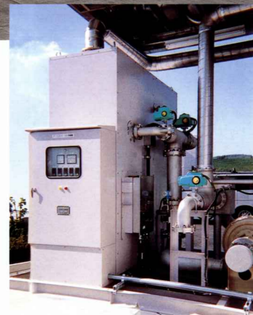
触媒燃焼式EOガス処理装置
